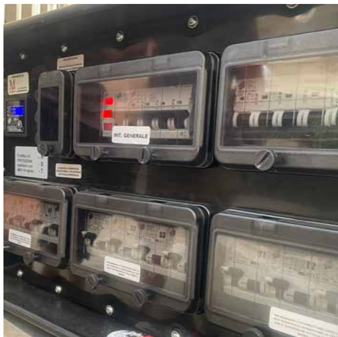
distribuzione elettrica per eventi
